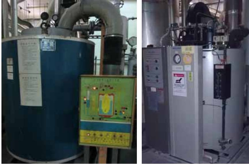
左為燃料油鍋爐 (改善前)，右為天然氣鍋爐 (改善後)
